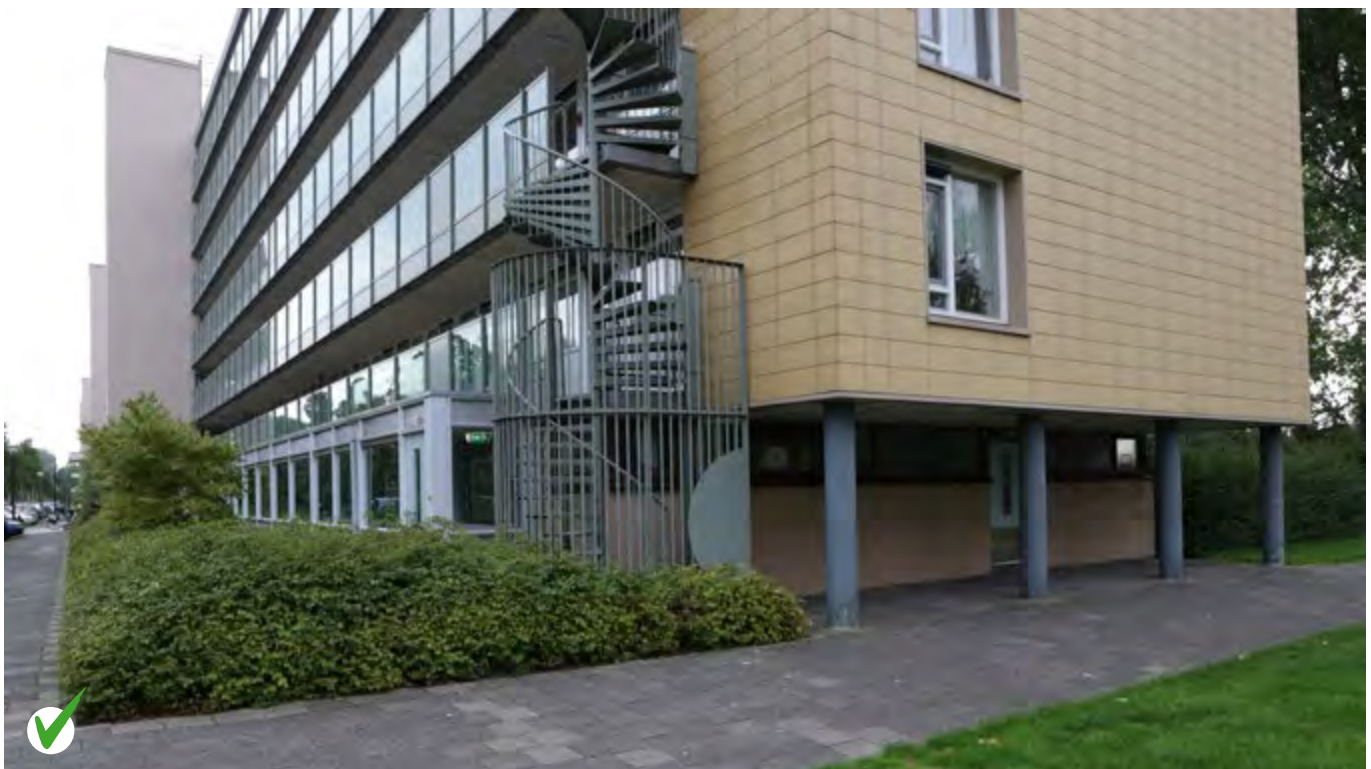
De afscherming van deze noodtrap is minimaal 2.85 meter.
