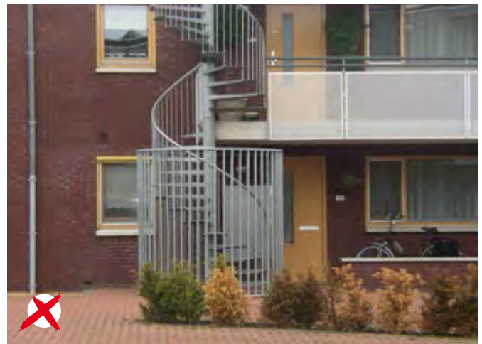
Fout: deze noodtrap is onvoldoende afgeschermd.
