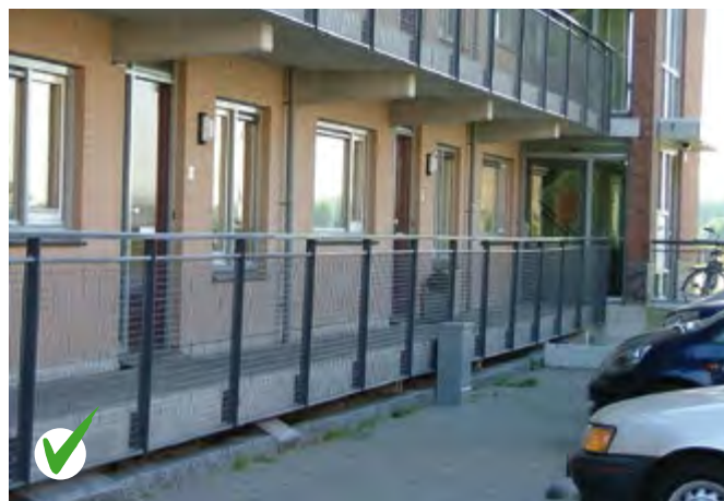
Goed: bij een galerij op de begane grond dienen de deuren naar de centrale ruimte conform G4 uitgevoerd te worden.
