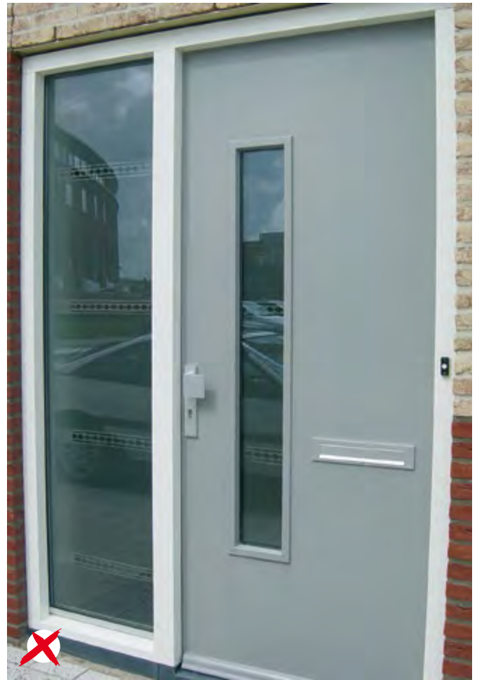
Fout: zorg dat bij blinding de doorkijkmogelijkheid blijft bestaan.
