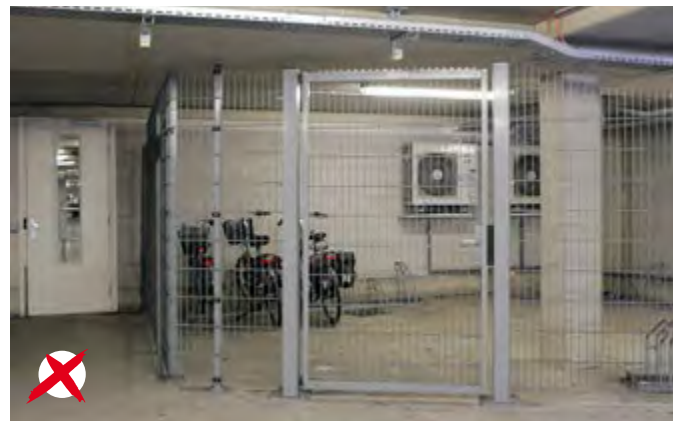
Fout: door de te grote (> 15 cm) opening aan de bovenzijde is deze stalling onvoldoende inbraakwerend.
